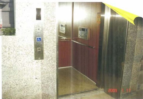
電梯設備（乘載10人）
