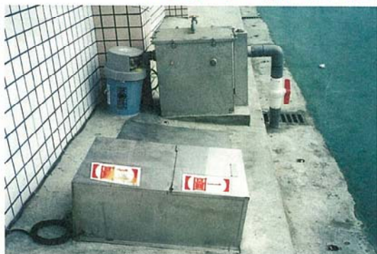
【圖一】自動除菜渣機及【圖二】油污槽
