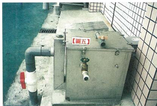
【圖五】油水分離機設備
