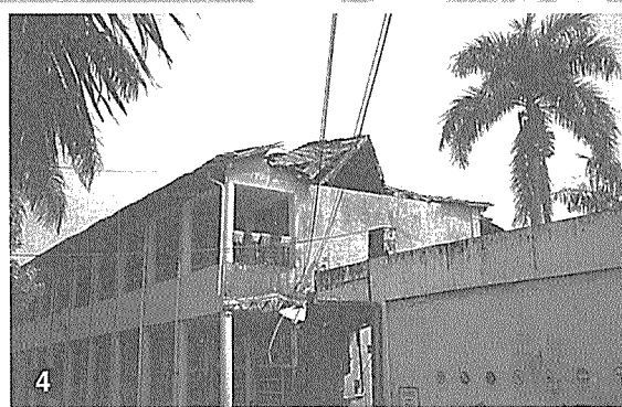
④ 教室屋頂掉落。
