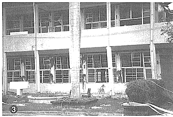
③ 整排教室柱子傾斜，鋼筋裸露。
