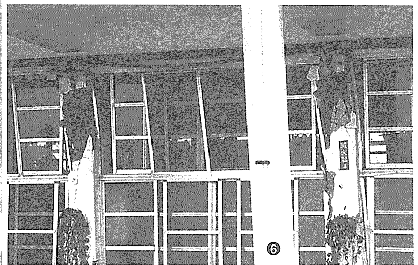
⑥ 教室柱子鋼筋裸露。
