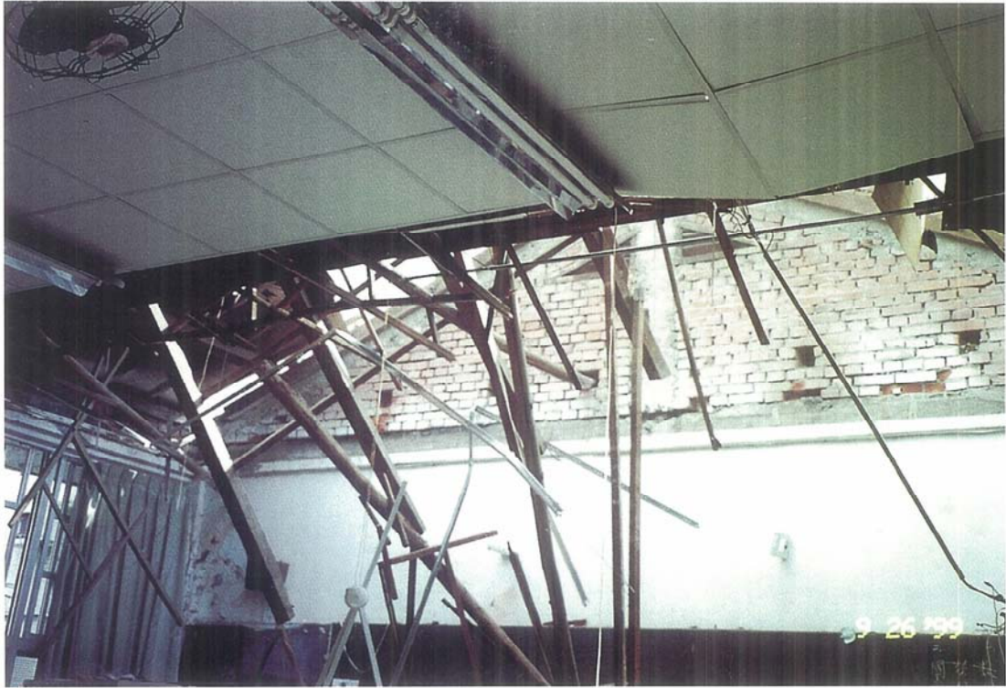
南棟教室屋頂塌陷嚴重
