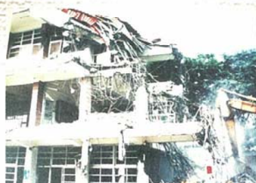
九二一地震後建築物倒塌
