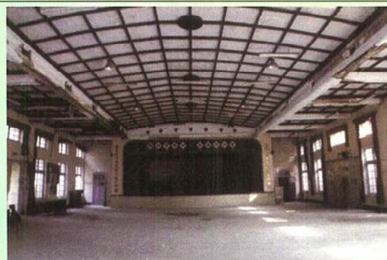
大禮堂室內-施工前(由西向入口往講堂拍攝)原講台立柱以裝修材料，覆蓋原有泥塑，藝術假樑因地震嚴重損壞。
