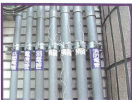
● 電源照明工程-管線集中部份94.2
