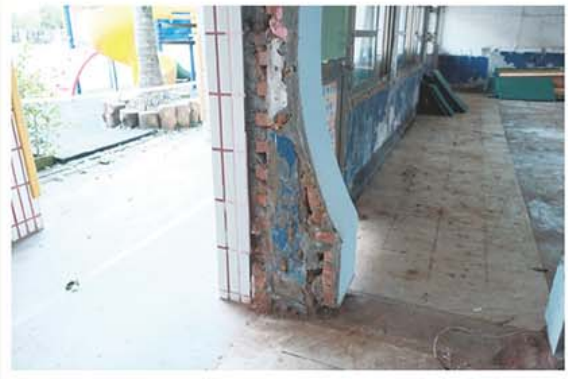
百年校慶前，進行幼兒園教室修繕工程，拆除原來的牆壁，露出一層層歷史的痕跡。
